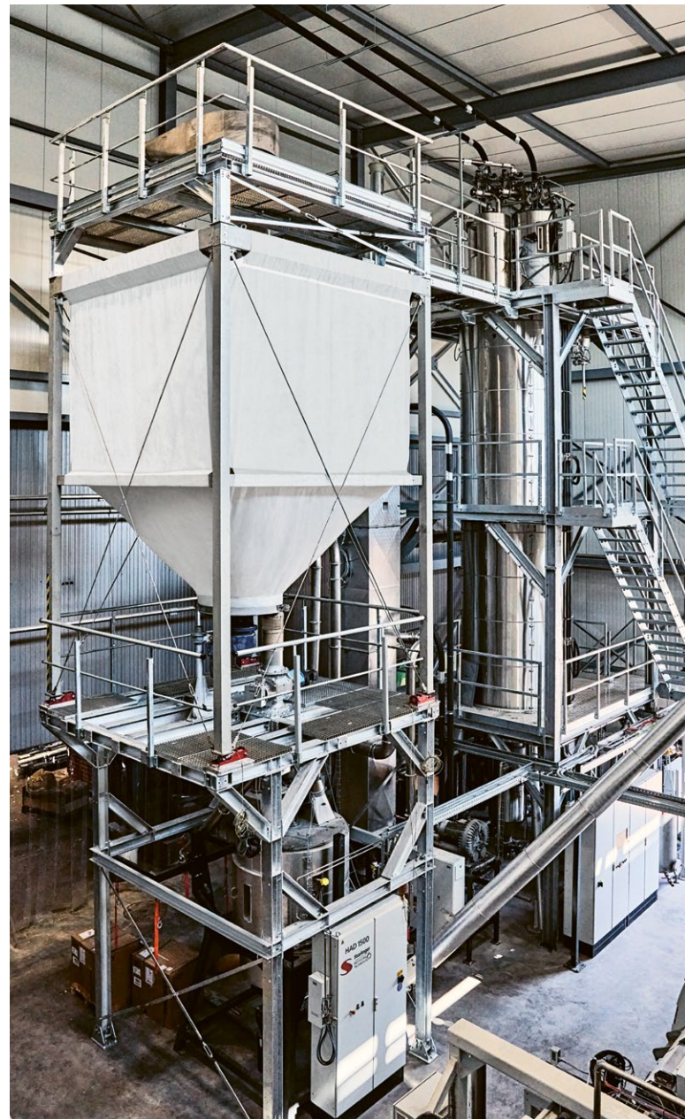
Bei RecyPet in Frauenfeld wurde eine neue Extruderanlage installiert, die PET-Getränkeflaschen zu lebensmitteltauglichem PET-Granulat verarbeitet.
