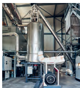
4 Nouvelle installation de valorisation du PET chez RecyPET
